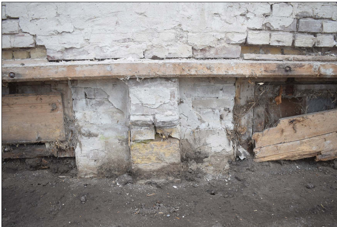
Afb. 123. Aanzet van een boog binnen de kelder, tegen de voorgevel aan.
