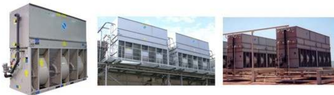
Figuras 79 – Exemplos de condensadores evaporativos
