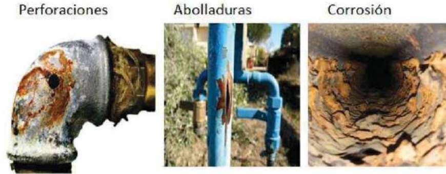
Figura 9. Posibles fallas identificables por visión desde el interior de la tubería.
