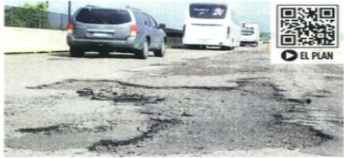
Las obras del Tren Maya dejaron casi mil kilómetros de carreteras dañadas, según datos de la SICT.
