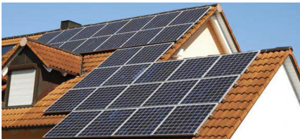
Figura 18: Placa fotovoltaica instalada em telhado residencial, disponível em: < http://www.placassolaresbrasil.com.br/ >. Acesso em 02/06/2016.
