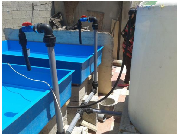
FIGURA 4.52 Tanques de fibra de vidro usados em uma unidade de leito de mídia
