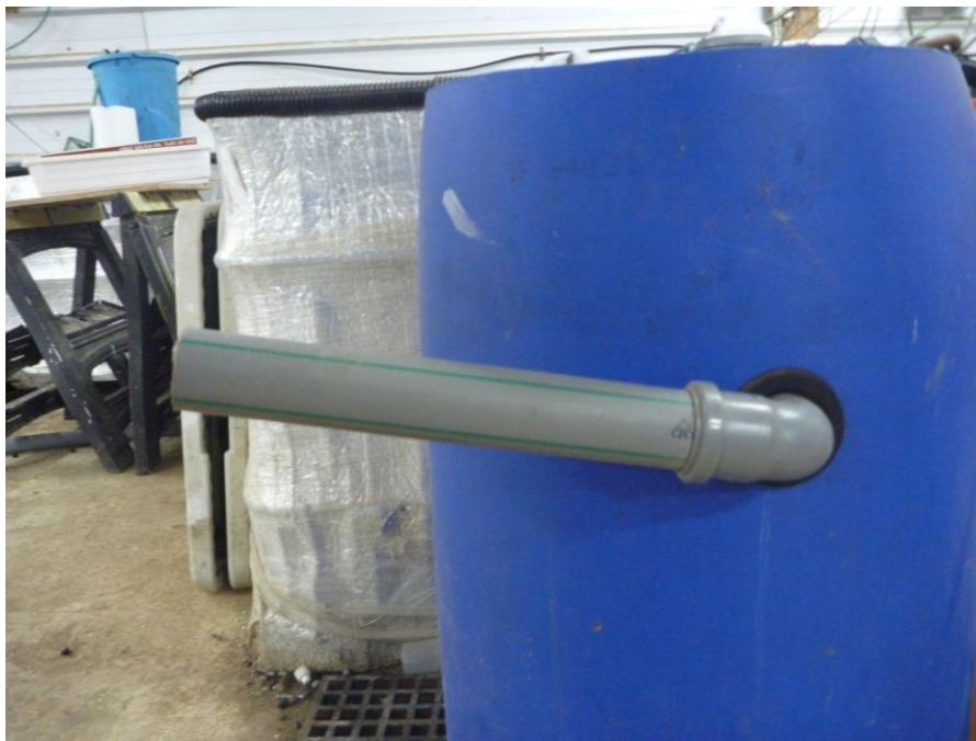
FIGURA 9.13 Tubo de transbordamento em um biofiltro
