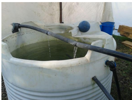
FIGURA 4.22 Um tanque de 1.000 L feito de um tambor de polietileno
