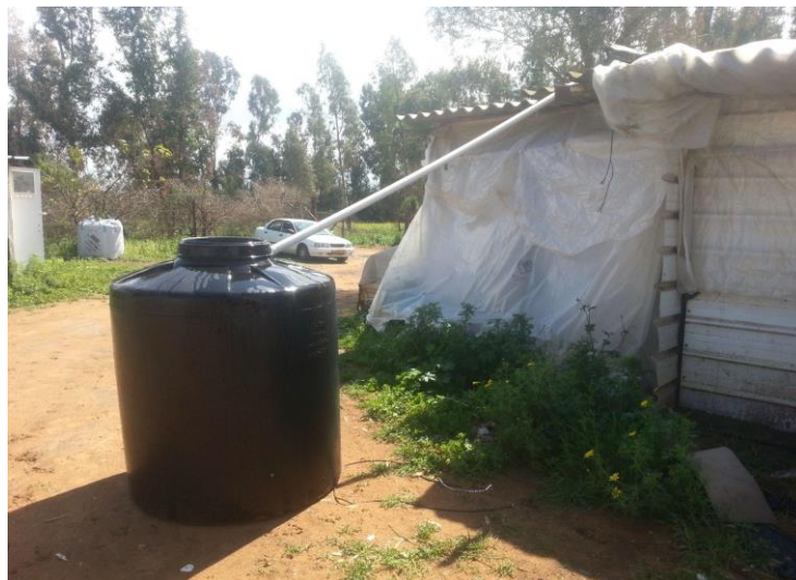
FIGURA 9.8 Coleta de água da chuva de um telhado
