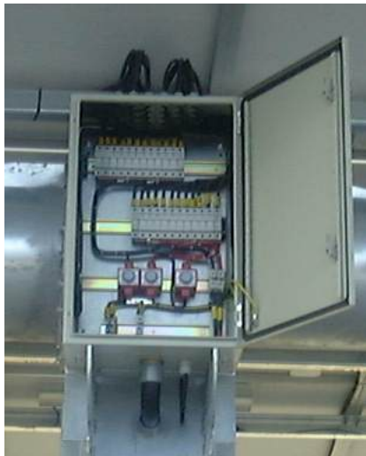
(A) Caja de protecciones
