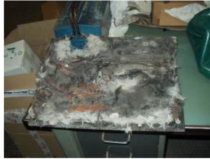
FIGURA 9.12: Efectos del funcionamiento de un diseño defectuoso de una caja de protecciones que incluye descargadores de tensión.
