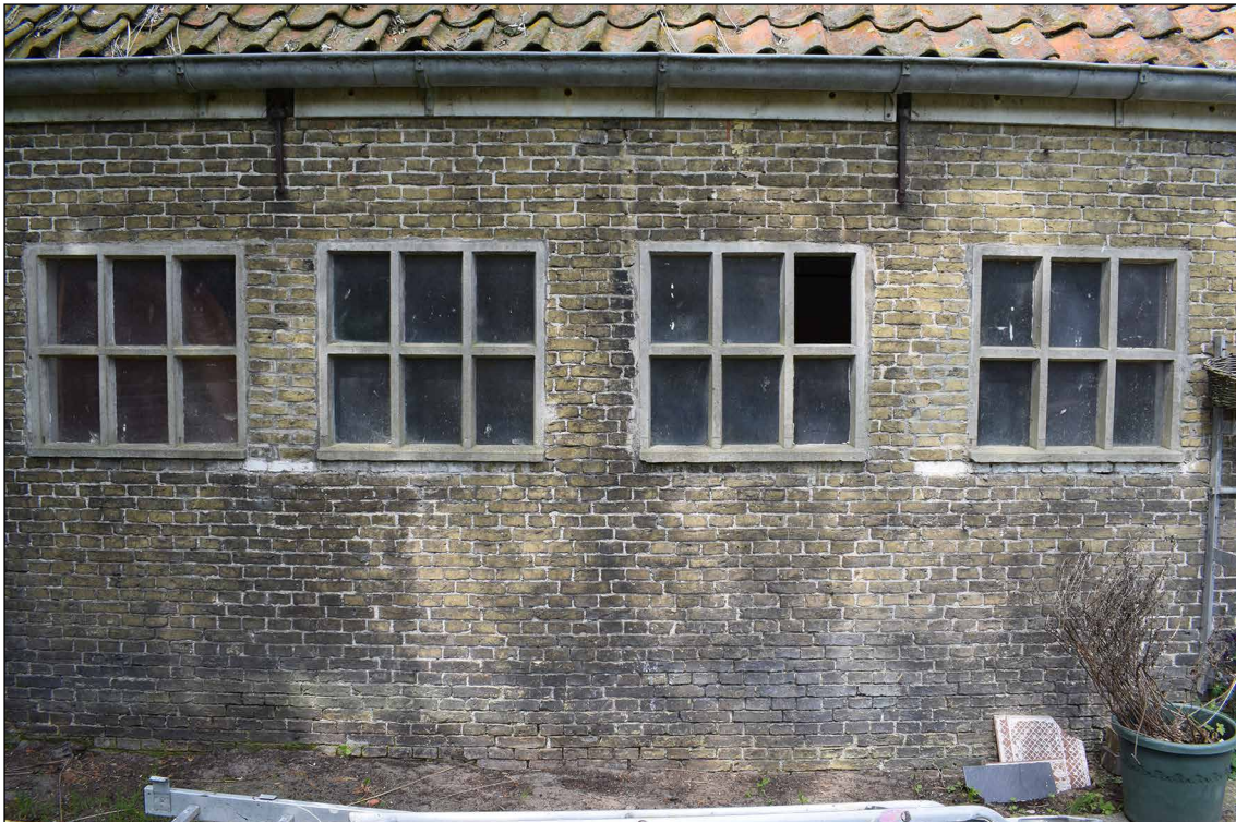
Afbeelding 15. De moderne betonramen in de oostgevel. Onder de ramen zijn twee rijen wit geverfde bakstenen zichtbaar. Zij zijn de restanten van de oorspronkelijke halfronde stalramen.
