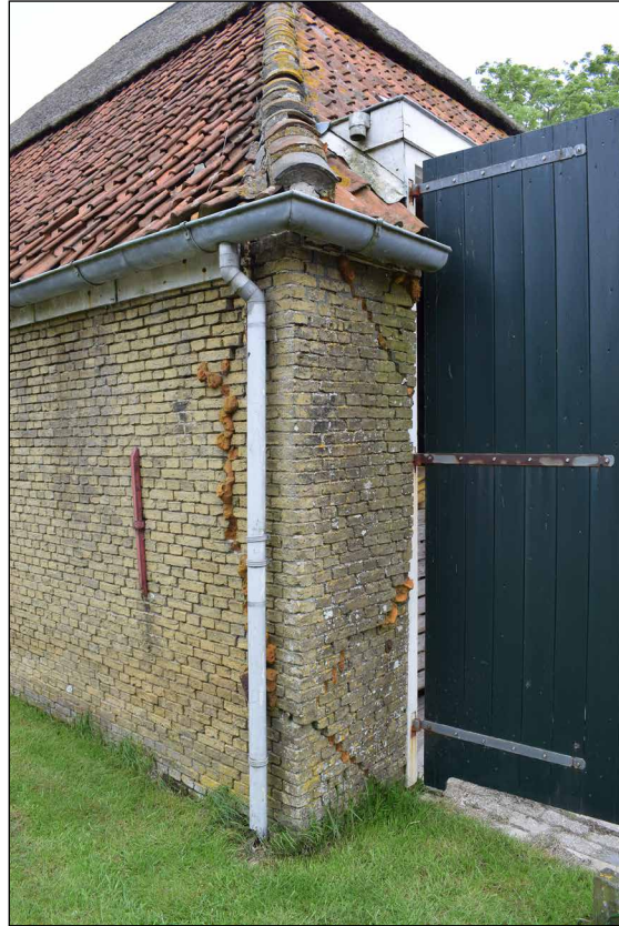
Afbeelding 11. Scheuren in de zuidwesthoek van de boerderij.
