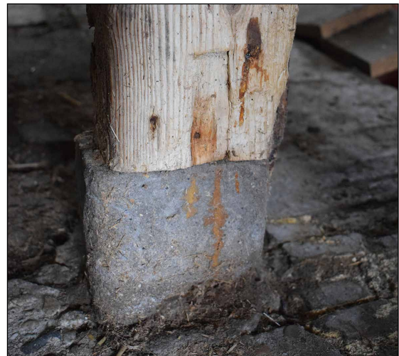
Afbeelding 36. Natuursteen blok onder een houten stijl.
