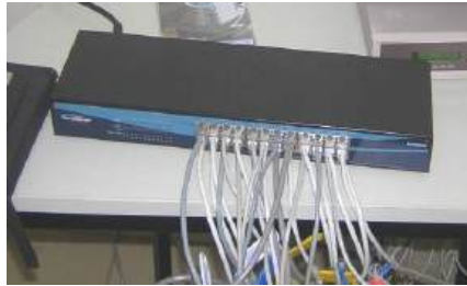
Figura 5.4 – Switch (comutador) com cabos UTP conectados
