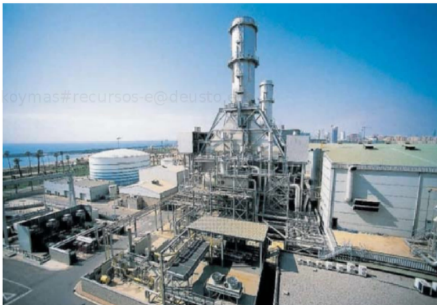
Central térmica de ciclo combinado (CTCC), en Sant Adrià de Besòs (Barcelona), en una foto de Endesa.
