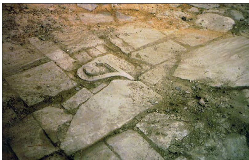
Afbeelding 5.3.137 Tijdens de werkzaamheden aan de duikersluis in 2008 kwam de kolk droog te liggen. De bodem bleek bedekt met hergebruikt bewerkt natuursteen. Naar Brokke 2012, afb. 61.
