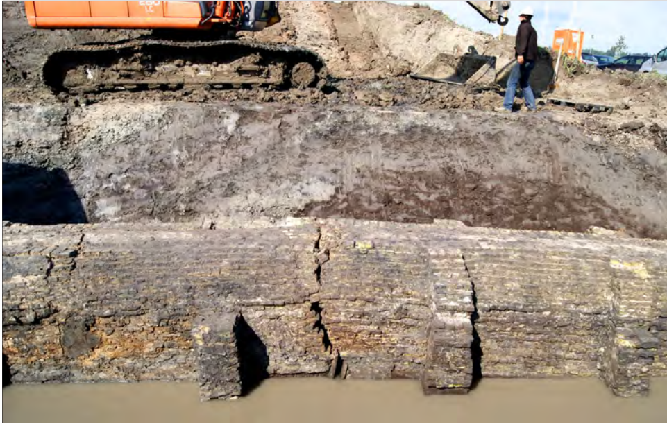
Afbeelding 5.6.8 De buitenkant van de koker tijdens het onderzoek van het ADC in 2011. De scheur ligt op de locatie van een knik in het metselwerk die mogelijk wijst op een gefaseerde aanleg. Op de achtergrond een deel van het dijkprofiel.
