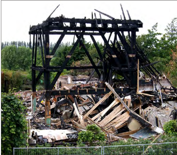
Afbeelding 5.3.115 In 2012 brandde een stolp af langs de Zuiderdijk 10. Aan de voorzijde is bovenop de overstekbalk te zien, die op de uitstekende vierkantdekbalken steunt.
