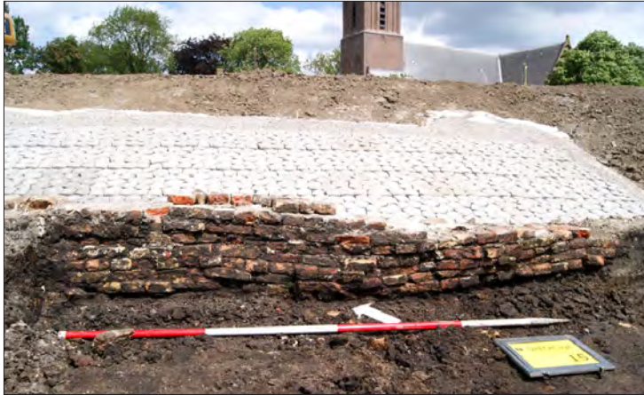
Afbeelding 5.3.98 Verzakking in het muurwerk.
