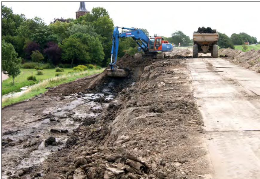
Afbeelding 5.3.34 De ontgravingswerkzaamheden in volle gang. De dumpers rijden over de nieuwe dijk. De dieplepelkraan graaft een groot deel van de oude kern weg.
