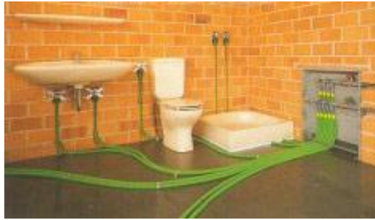
Şekil 2.3. Termoplastik boru ile döşenmiş banyo tesisatı
