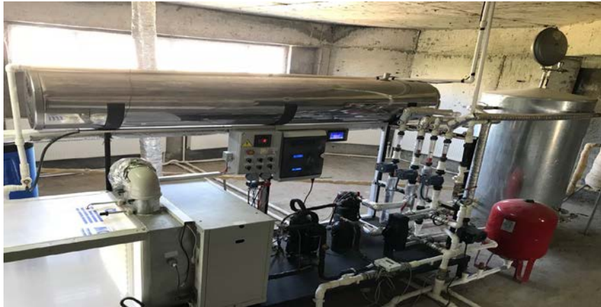
Şekil 2. Isı Pompalı Isıtma Sistemi Deney Düzeneği
