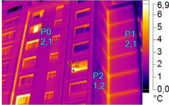
Şekil-38. Yalıtım öncesi ön sağ üst termal ölçümü
