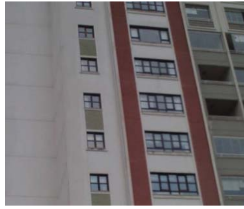
Şekil-27. Yalıtım öncesi arka üst fotoğrafı
