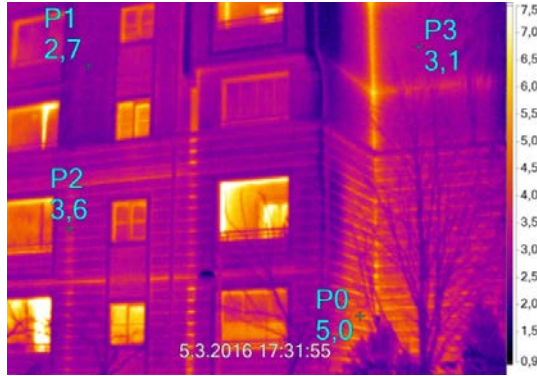
Şekil-22. Yalıtım öncesi sağ alt termal ölçümü
