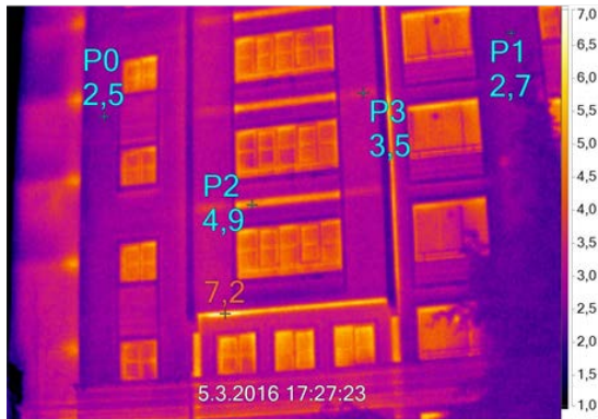
Şekil-24. Yalıtım öncesi sağ alt termal ölçümü
