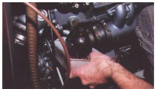
3 Vidangez. Notez le faible débit dû à l'obturation partielle de l'orifice de vidange par des dépôts et la couleur rouille du liquide.
