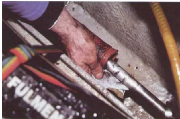
4 Après un bon nettoyage de cale, nettoyez et contrôlez l'arbre d'hélice, la durit de raccordement ainsi que ses colliers. Remarquez les traces de corrosion au niveau de l'emplacement des garnitures. L'arbre est piqué.
