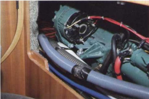
1 Repérez l'emplacement de l'alternateur et son accessibilité. Représentez sur une feuille l'implantation des bornes, la couleur des fils et leur position respective.
