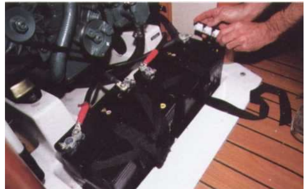
1 Le contrôle du niveau de l'électrolyte est un contrôle fastidieux mais nécessaire, l'électrolyte s'évaporant pendant les cycles de charge et de décharge de la batterie.
