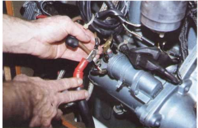
3 Déconnectez chacun des fils tout en vérifiant l'état des cosses, la propreté mais aussi le sertissage des fils.
