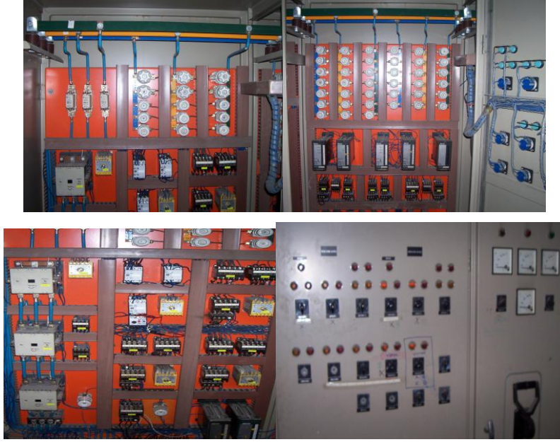
Resim 1.6: Merkezî iklimlendirme ve havalandırma santralının kumanda panolarının iç ve dış görünüşleri
