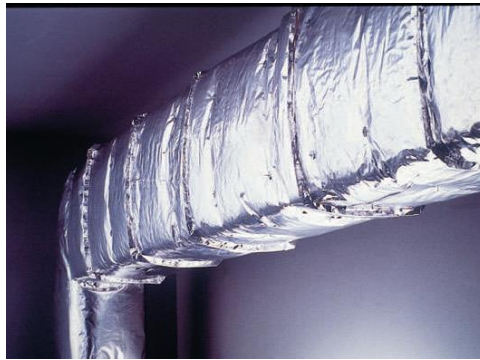
Resim 4.10: Yalıtım yapılmış hava kanalı
