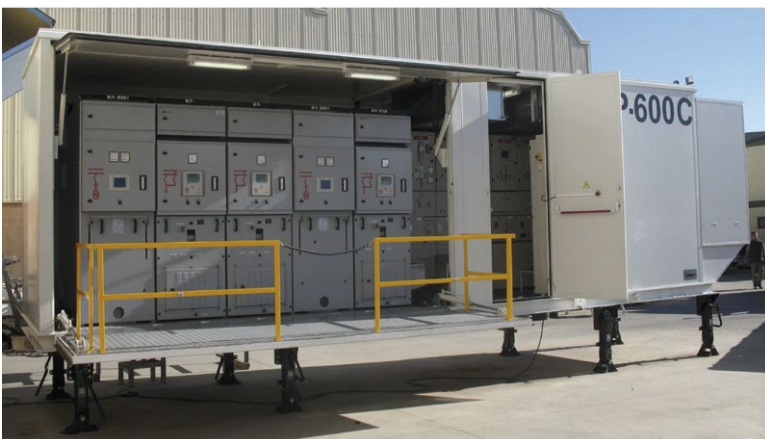
Subestación móvil 15kV
