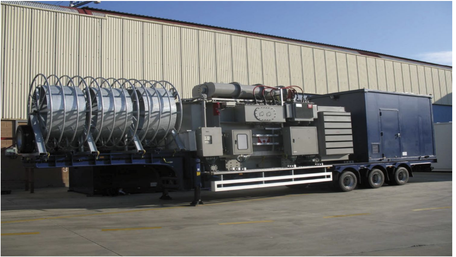
Posición de transformador móvil 45-15kV
