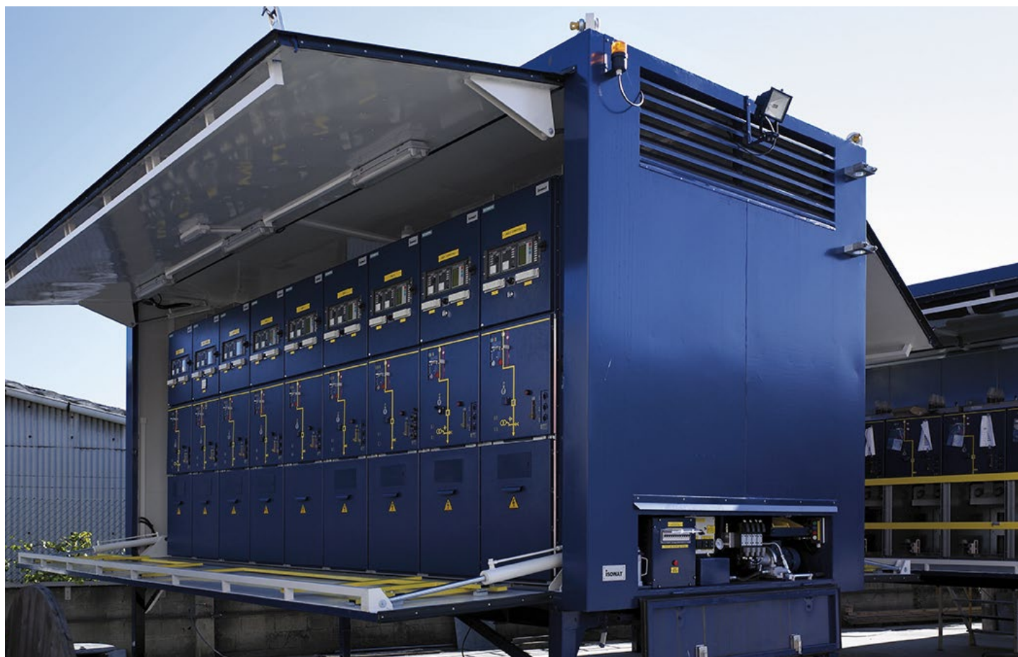
Subestación móvil 15-20kV
