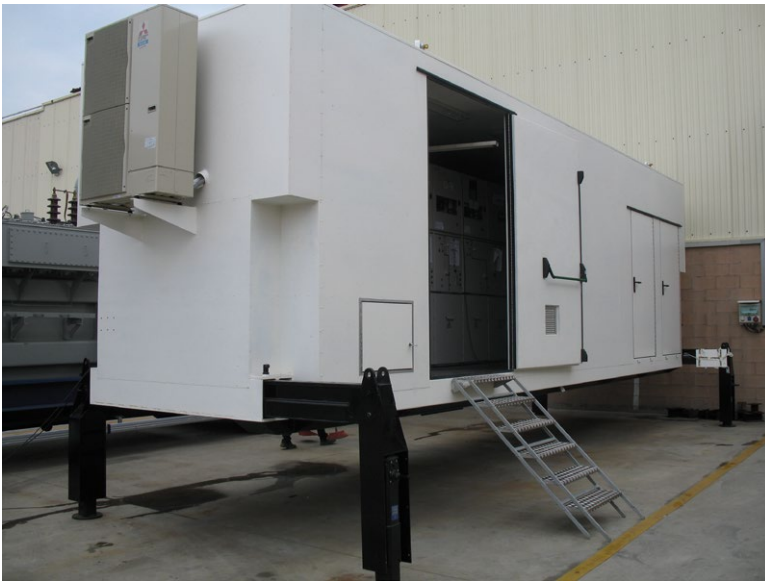
Subestación móvil MT
