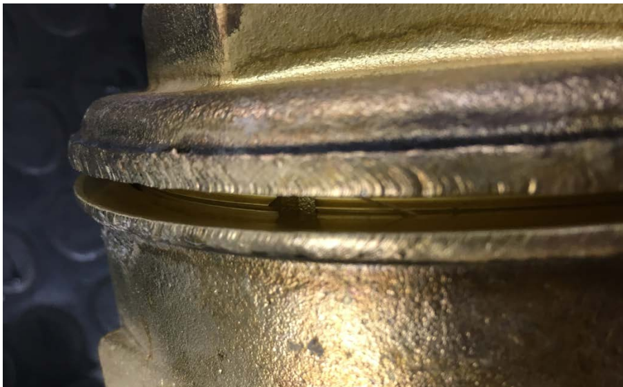
Şekil 10. Aşırı basınç altında kaynak yerinden ayrılan soğutucu küresel valf
