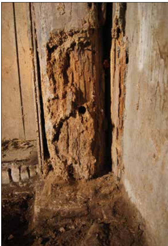
Afb. 53. Onderkant van de zuidoostelijke stijl met daaronder halfvergaan peulhout en de bakstenen poer.
