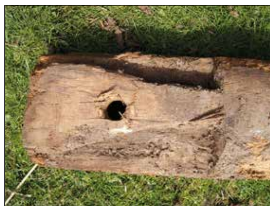
Afb. 55. Bovenzijde van de zuidelijke dekbalk met een voorloef.
