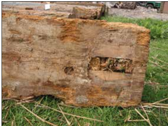
Afb. 51. Onderkant van de noordelijke dekbalk met een pengat.
