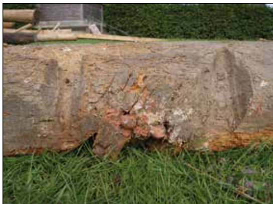
Afb. 58. De zuidelijke dekbalk met een afgebroken zwing (lipverbinding met hak) en inkepingen van sparren op de bovenhoek van de balk.
