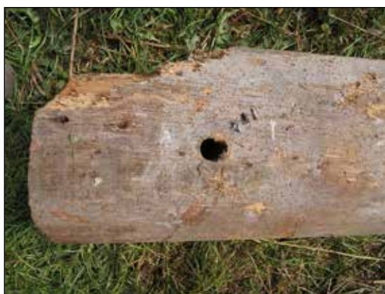
Afb. 54. Rond gat in de onderzijde van een van de stijlen.
