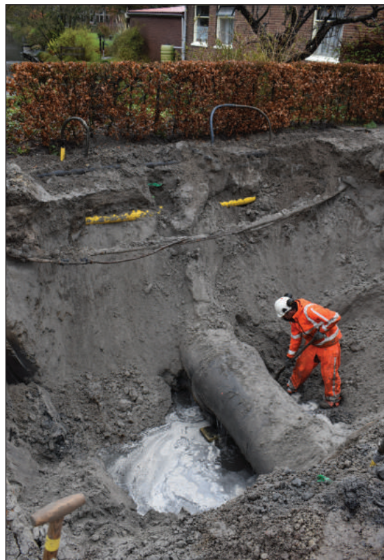
Afb. 77. De situatie ter hoogte van de sloot tussen Westeinde 14 en 16 in Venhuizen met in het midden de gebroken duiker uit de jaren zeventig.
