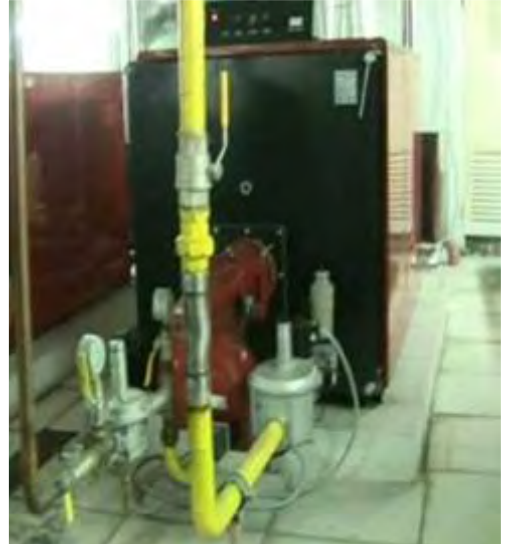
Doğalgaz ile Çalışan Sistem
