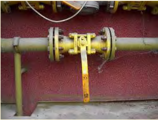
Doğalgaz Vanasının Kapatılması
