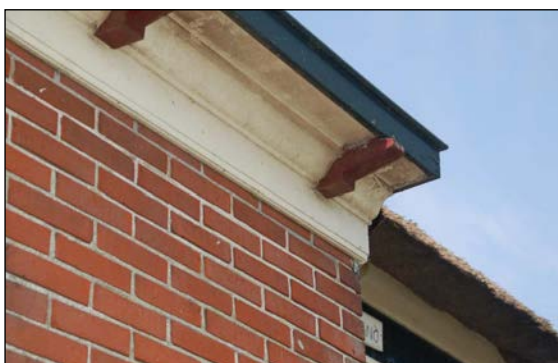
Afb. 19 Gootklossen onder de bakgoot aan de voorgevel van de stolpboerderij uit 1940.
