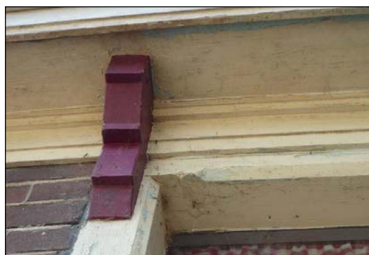
Afb. 20 Gootklossen onder de bakgoot aan de rechteraanbouw.
