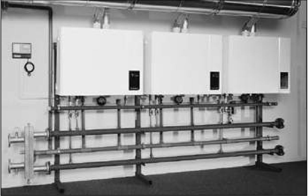
Şekil 192. %109 VERİMLİ DUVAR TİPİ YOĞUŞMALI KAZANLAR (30 DAİRELİ BİR APARTMAN KAZAN DAİRESİ ALANI 8m 2 )
