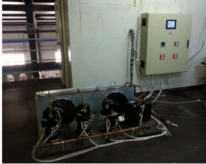
Şekil 1. Soğuk depo, dış ünite ve kontrol panosunun görünümü
