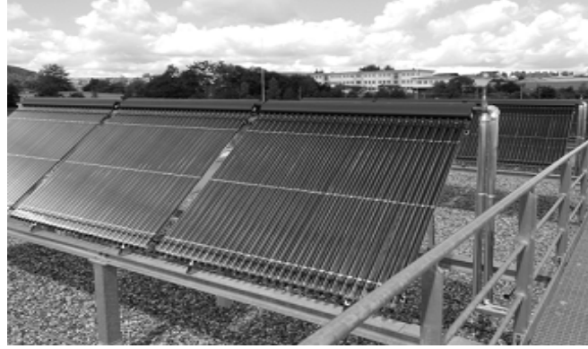
Şekil 1. Vakum tüplü güneş kolektörleri örnek uygulaması [7]
