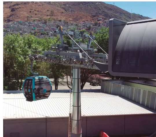
Estación Indios Verdes, pruebas de sistema electromecánico.
