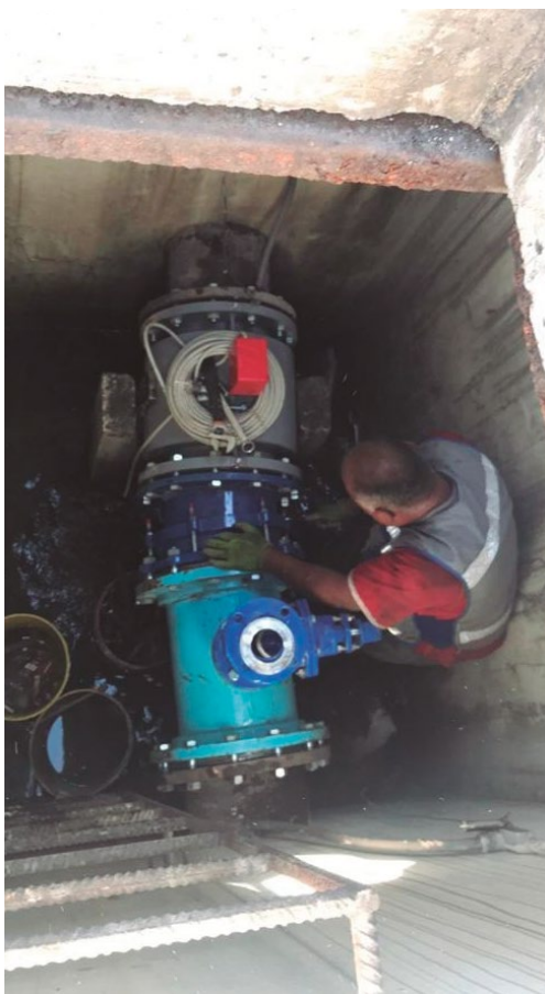
Instalación de medidor de gasto en sector AOB.
