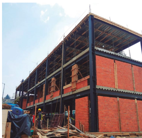
Habilitado de muro en estructura a base de vigas y columnas metálica para el edificio educativo de la Universidad "El Oasis"
