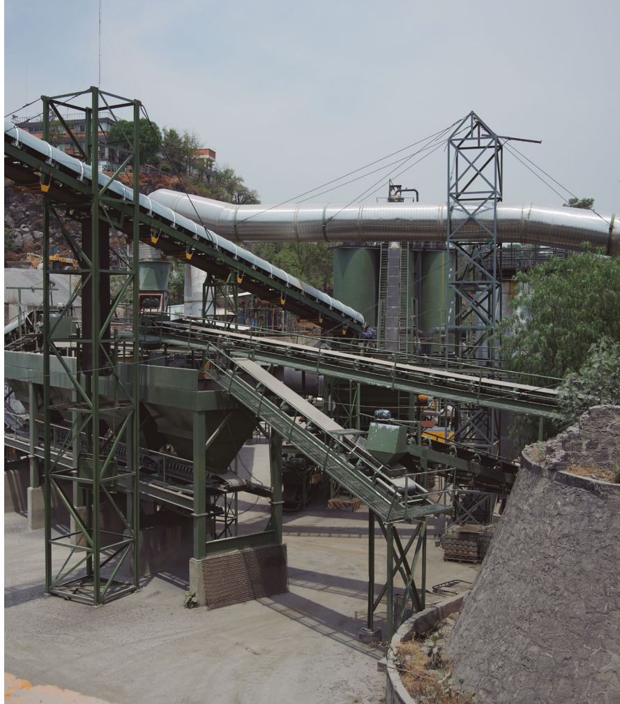
Planta de elaboración de mezcla asfáltica.
