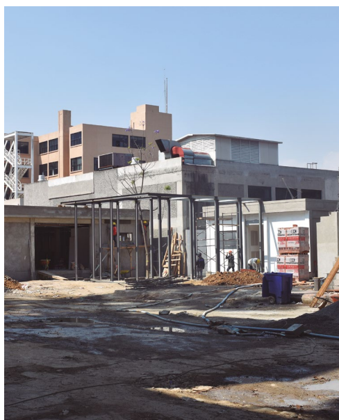
Trabajos de construcción en el acceso principal del Centro Especializado en Medicina Integrativa (CEMI), en la Alcaldía Miguel Hidalgo.
