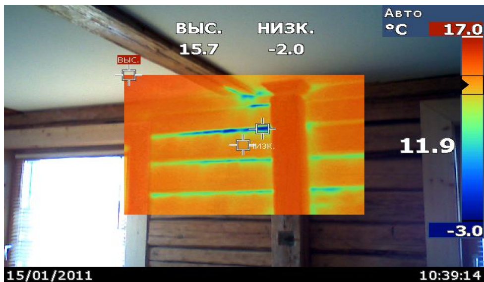
3-5.att. Termiskie tilti ēkas būvkonstrukciju (ārsienu – 1.stāva pārsegums) plakņu krustpunktos un starp guļbūves balķu savienojumiem. ( nepietiekama siltumizolācija no ēkas ārpuses)
