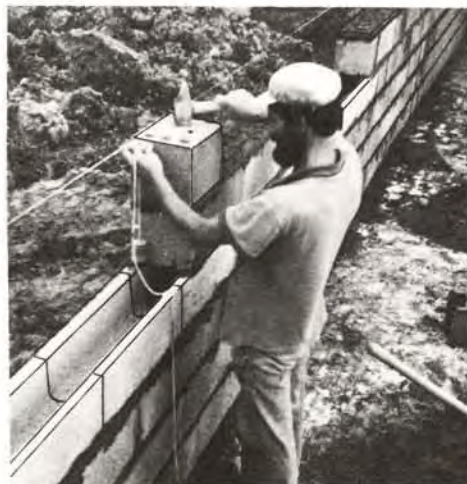
⑪ Réglage d'un bloc de jambage au fil à plomb. Un chaînage filant est prévu sous les jambages
