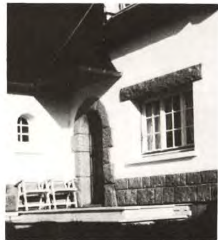
④ Soubassement, porte d'entrée, linteau, en pierres de taille. Auvent protecteur au-dessus de la porte d'entrée
