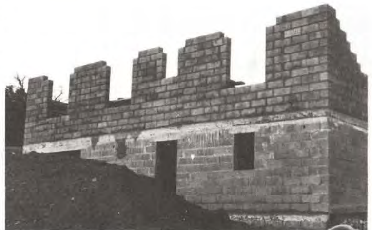
③ Mur de façade réalisé avec des blocs creux de béton de 20 cm \times 20 cm \times 50 cm
