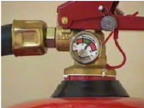
Yangın Söndürme Cihazının Manometresi
