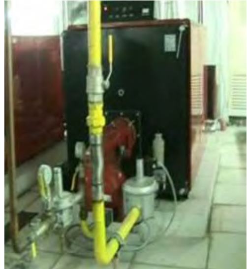
Doğalgaz ile Çalışan Sistem
