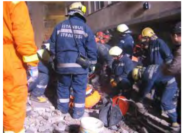
Kumkapı'da Yaşlı Bina Çökmesi Sonrası Arama-Kurtarma Çalışmaları
