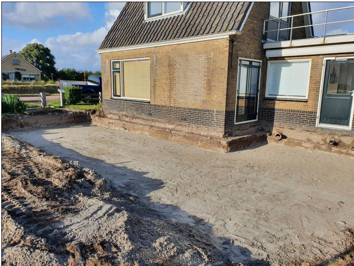
Aan Oost 2 op Texel is de bouwput uitgegraven en aangevuld met zand waardoor archeologische waarnemingen niet meer mogelijk waren.
