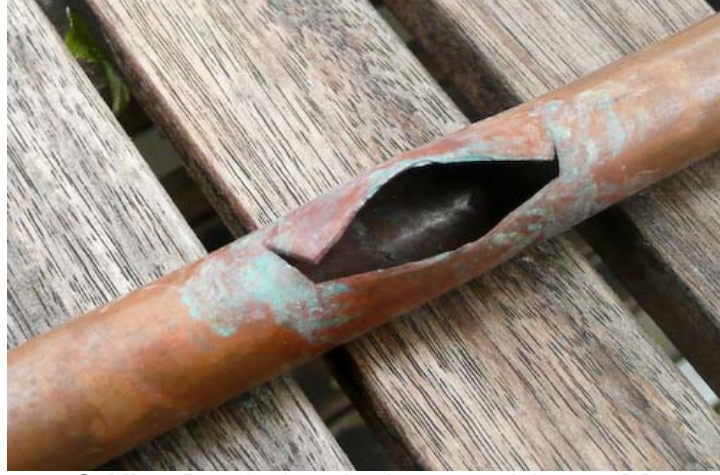
Şekil 2. Boru hatlarında oluşan örnek hasar [2].
