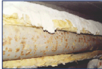
Resim1.17: Yoğuşma sonucu kanalın yalıtımının deformasyonu
