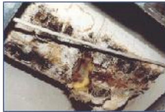
Resim1.17: Yoğuşma sonucu kanalın yalıtımının deformasyonu
