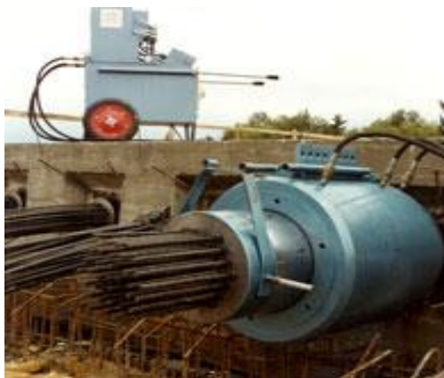
Cordones del postesado de un puente
