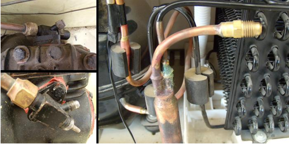
Resim 2.2: Servis borusu bağlantı noktaları
