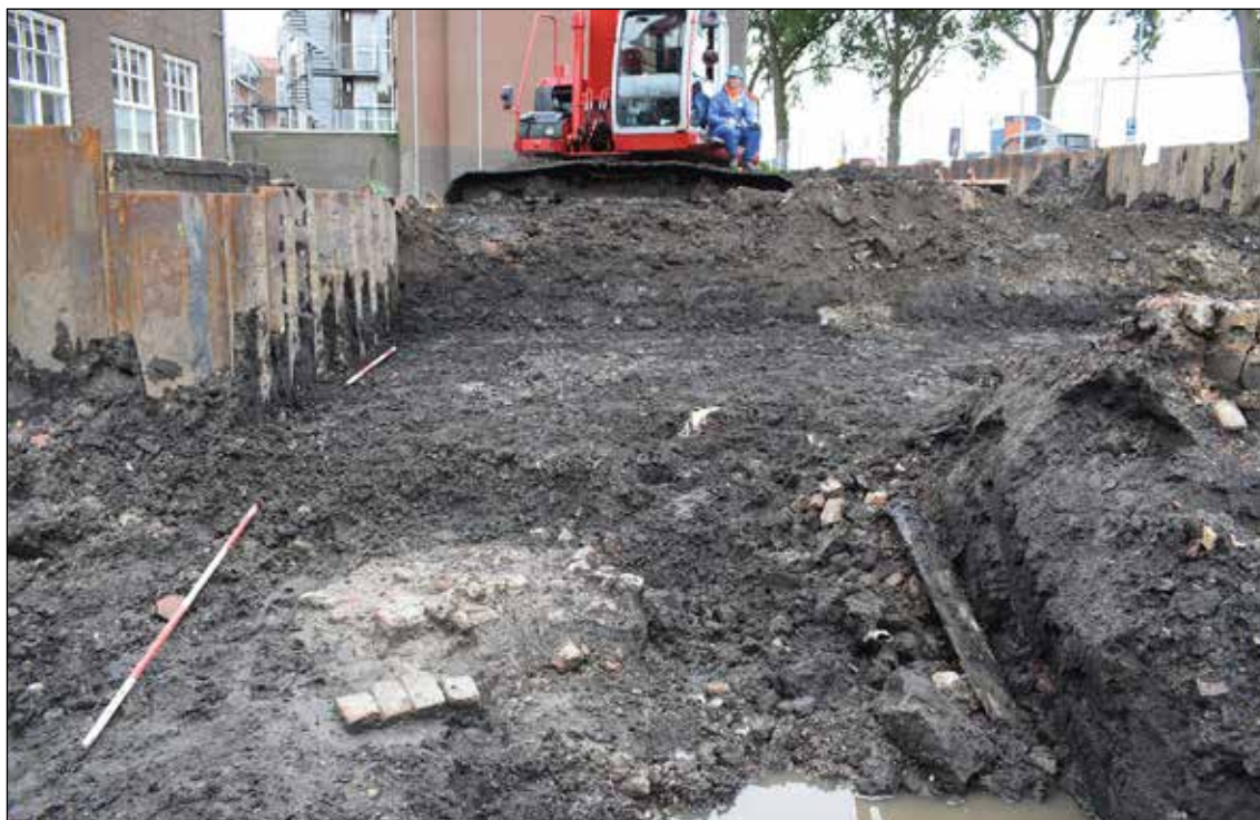
Afb 5.5 Opgraving van perceel 1, kijkend richting het zuiden. Op de voorgrond een spoor met mortel en baksteenpuin, vermoedelijk het restant van een van de vier poeren van de standerdmolen.
