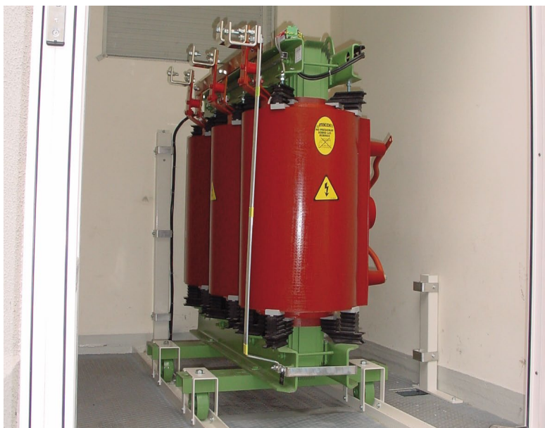
Trafo SSAA interior edificio A11
