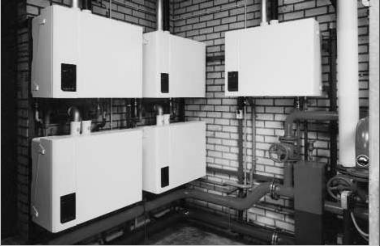
Şekil 3.4 / %109 VERİMLİ DUVAR TİPİ YOĞUŞMALI KAZANLAR (45 DAİRELİ BİR APARTMAN KAZAN DAİRESİ ALANI 14m 2 )
