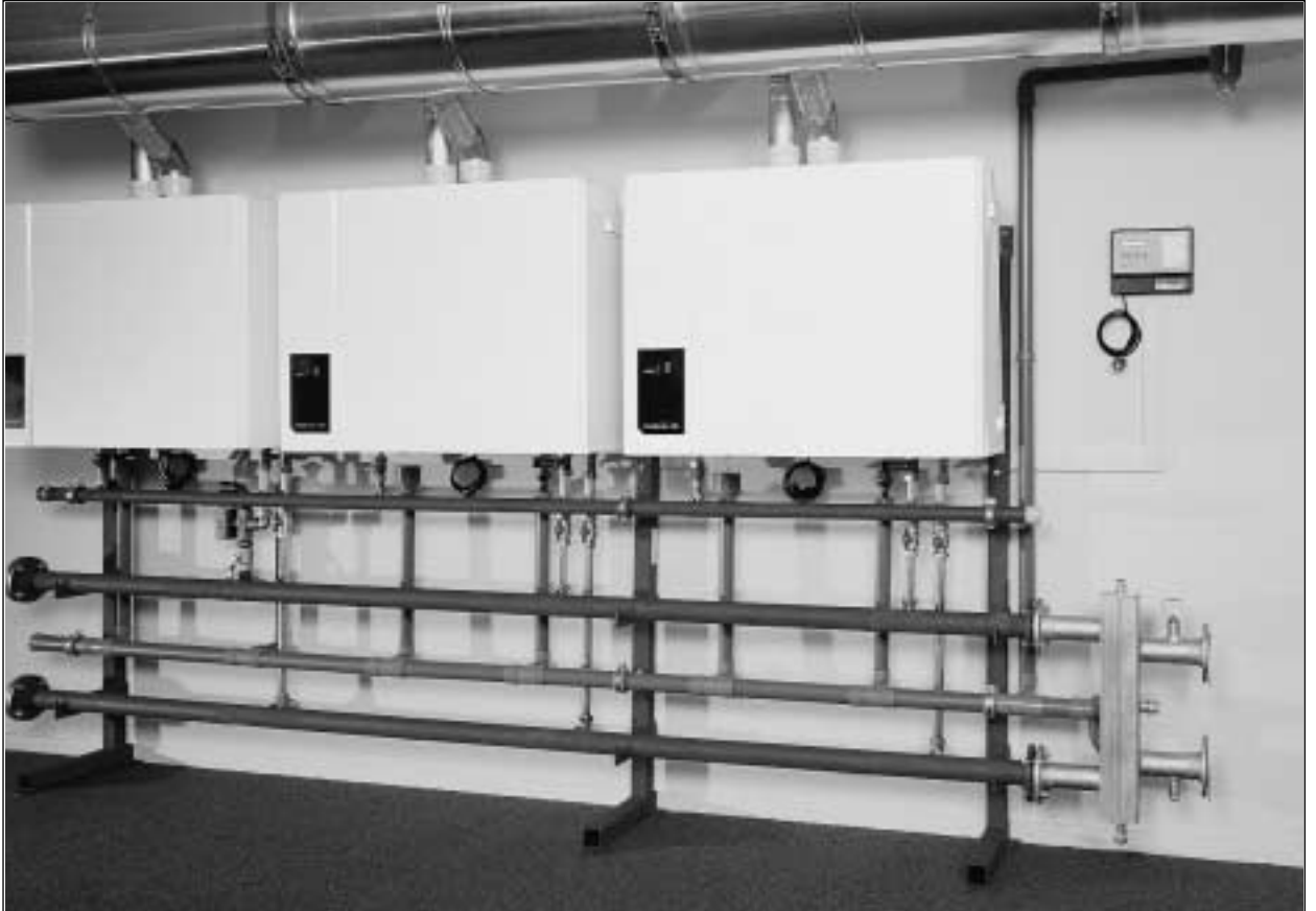
Şekil 3.3 / %109 VERİMLİ DUVAR TİPİ YOĞUŞMALI KAZANLAR (30 DAİRELİ BİR APARTMAN KAZAN DAİRESİ ALANI 8m 2 )
