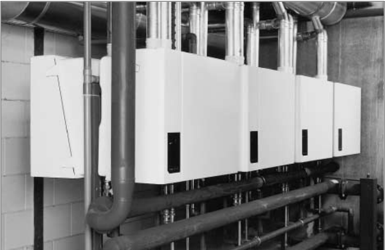
Şekil 3.5 / %109 VERİMLİ DUVAR TİPİ YOĞUŞMALI KAZANLAR (70 DAİRELİ BİR APARTMAN KAZAN DAİRESİ ALANI 20m 2 )
