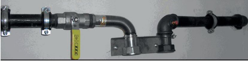
Şekil 26 Doğal Gaz Sayaç Montaj Yeri
