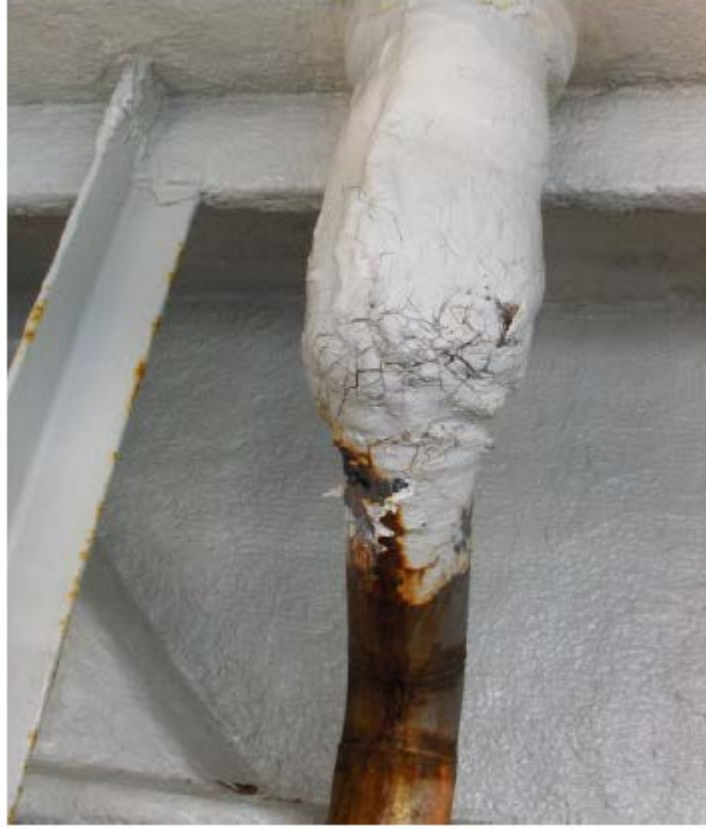
Şekil 10. Kuzey Denizi'nde bulunan bir Petrol Platformunda yalıtımlı borularda gözlemlenen Çatlak Korozyonu [8]
