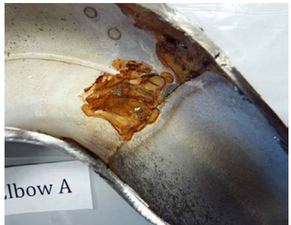
Şekil 9. Boru ek yerinde Çatlak Korozyonu oluşumu (NACE)
