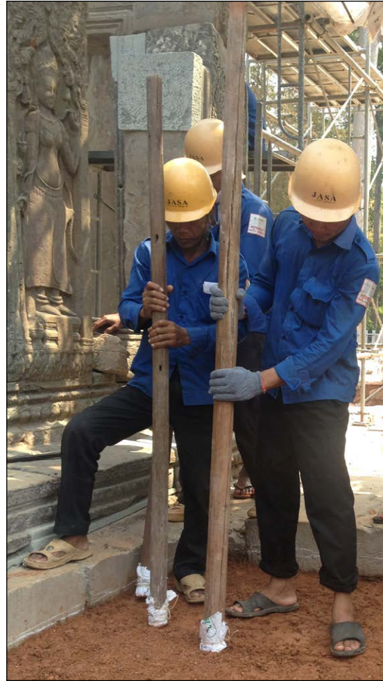
Afb. 92 Traditionele grondverdichting in Angkor Thom (Cambodja). Voorafgaand aan het plaatsen van een zware constructie, wordt het oppervlak met klei en leem verdicht.
