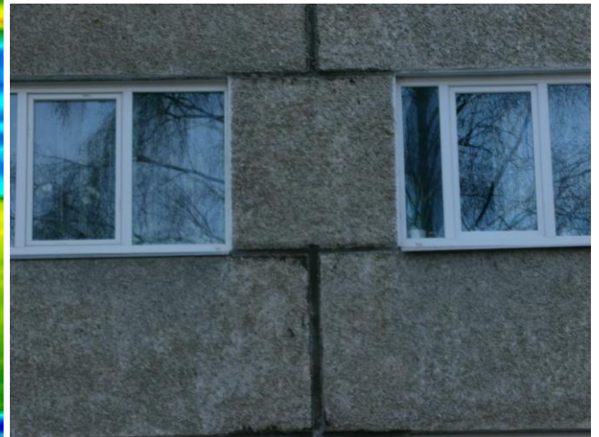
Lineārie termiskie tilti vertikali plakņu krustpunktos( bloku montāžas šuvju vietās). Siltuma noplūde ēkas ārsienas paneļu vājinājuma vietās. Nepieciešams veikt sienas siltināšanu.
