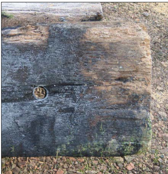
Afb. 54 Een rond gat aan de onderzijde van een vierkantstijl.
