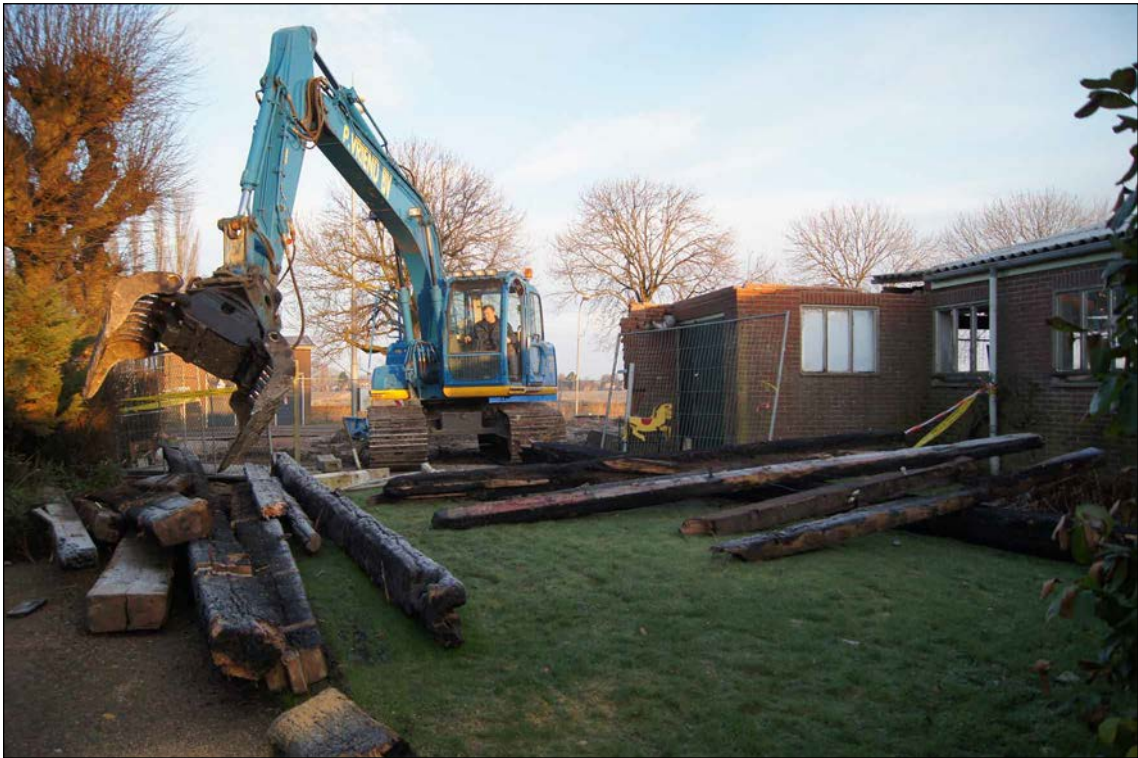
Afb. 60 De balken van het vierkant worden bij de sloop apart gelegd voor nader onderzoek.
