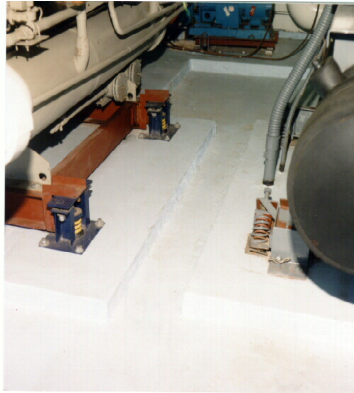
Şekil 4.5 Sismik Korumalı Ekipman Örneği[1]
