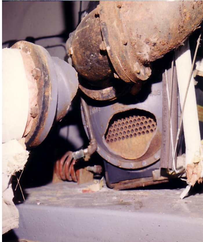
Şekil 4.3 Zarar Görmüş Ekipman Örneği[1]
