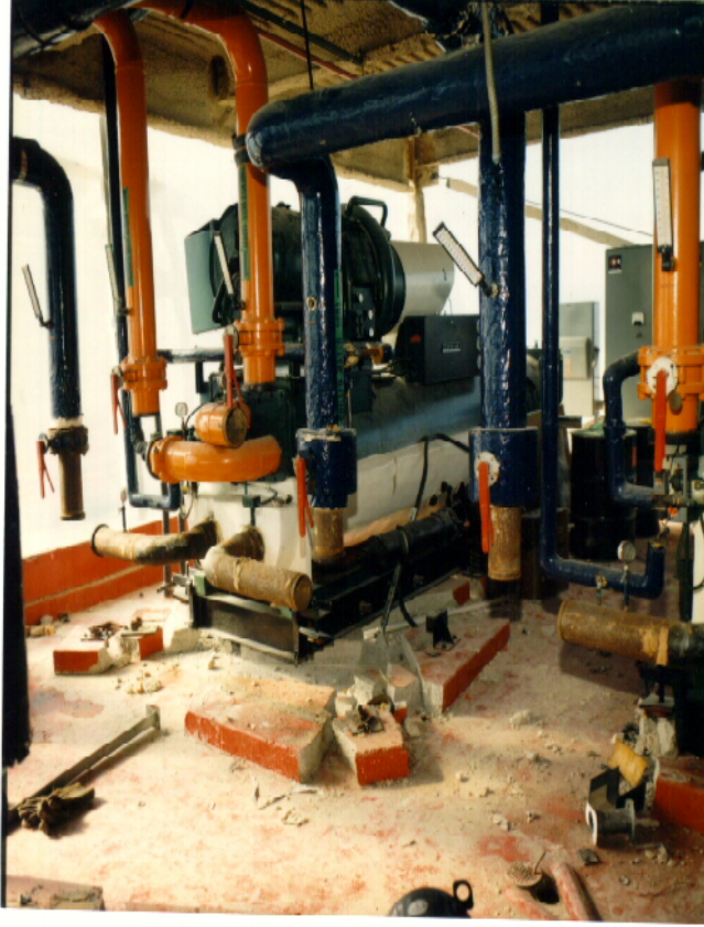
Şekil 4.2 Zarar Görmüş Ekipman Örneği[1]
