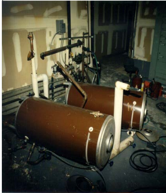
Şekil 4.1. Zarar Görmüş Ekipman Örneği[1]
