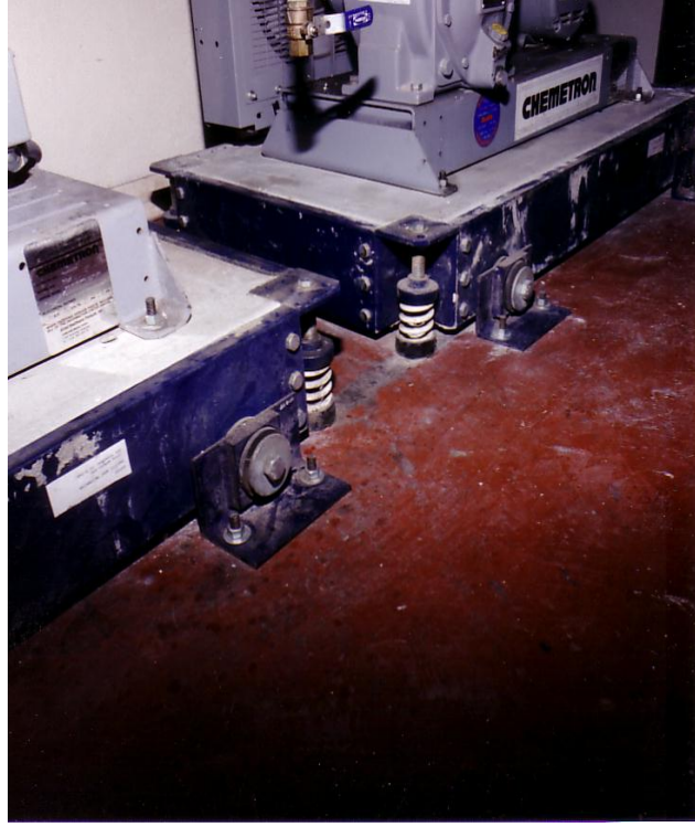
Şekil 4.4 Sismik Korumalı Ekipman Örneği[1]
