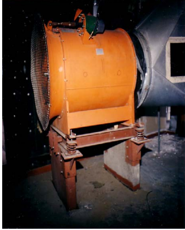
Şekil 4.6 Sismik Korumalı Ekipman Örneği[1]
