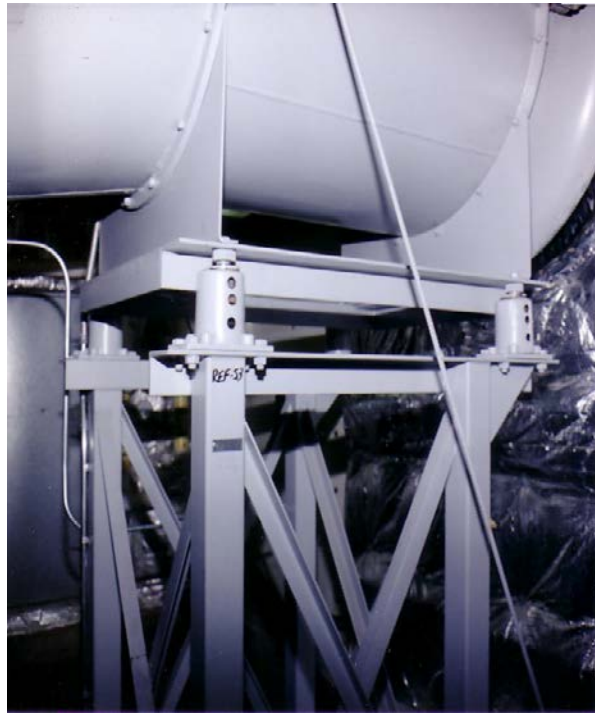
Şekil 4.7 Sismik Korumalı Ekipman Örneği[1]
