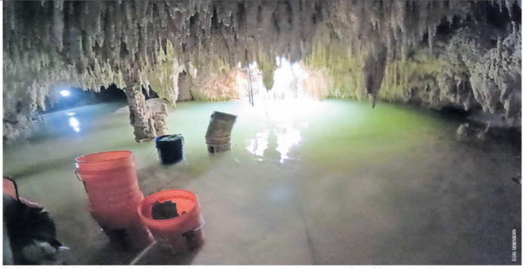
En el informe se detalla que al colocar los pilotes hubo afectaciones en las cavernas sobre las que corre el Tramo 5 Sur, como la caída de cemento en el agua.
